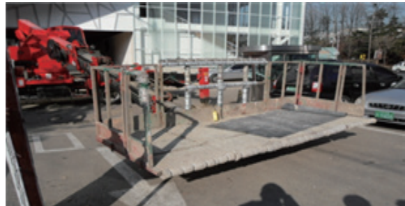
안전난간대 미설치 작업대 하강 중 떨어짐
