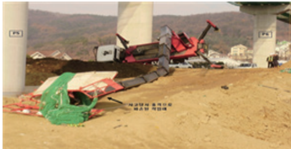
허용 작업반경 초과로 작업중 전도
