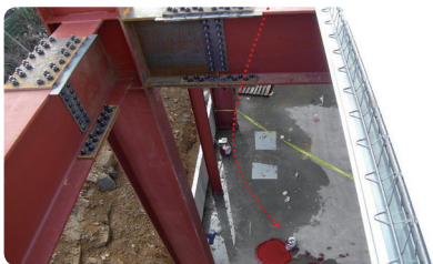
데크 설치 중 5m 아래로 떨어져 2명 사상('15. 11. 14, 경북 구미)
