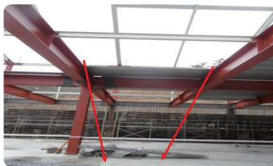
데크 설치 중 7m 아래로 떨어져 2명 사상('14. 12. 31, 경남 고성)
