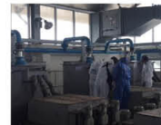
2층 기계식 농축기
