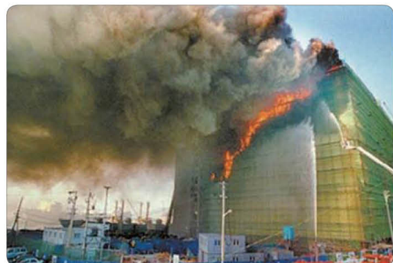
부산 냉동창고 신축공사 화재 ('98.10.29. 사망 27, 부상 16)
