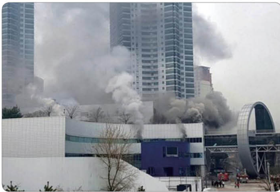
상가 매장 복구공사 중 화재 ('17.2.4. 사망 4, 부상 47)
