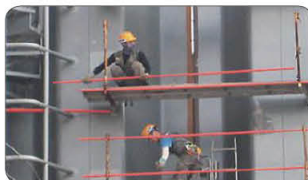
안전난간 설치(안전대 미착용)
