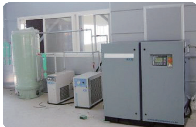
Máy nén khí trục vít quay với bình khí 스크류 타입 공기압축기 및 공기저장탱크
