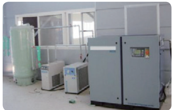
ปั๊มลมแบบสกรูหมุนที่มากับถังบรรจุก๊าซ 스크류 타입 공기압축기 및 공기저장탱크
