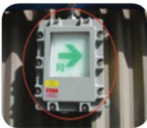
Đèn dẫn hướng chống cháy
