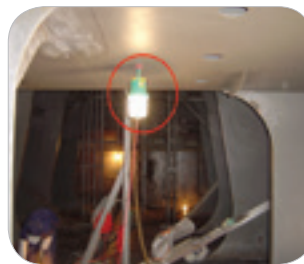
Hệ thống ánh sáng tạm thời chống cháy
