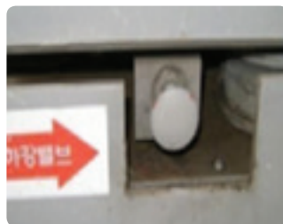
Thiết bị An toàn Khẩn cấp (Van Hạ) 비상안전장치(하강밸브)
