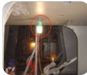
Flameproof temporary lighting 방폭형 임시 조명등
