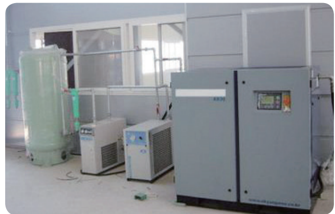
Rotary screw air compressor with an air tank 스크류 타입 공기압축기 및 공기저장탱크
