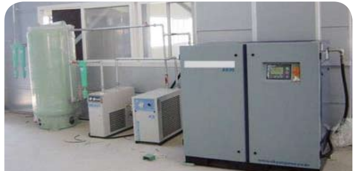
스크류 타입 공기압축기 및 공기저장탱크
