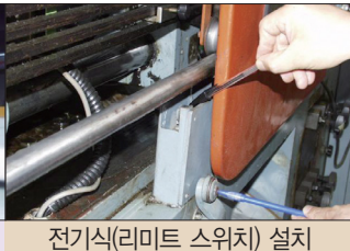
전기식(리미트 스위치) 설치
