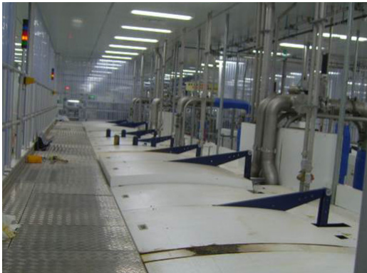
[화재가 발생한 체임버 상부]
