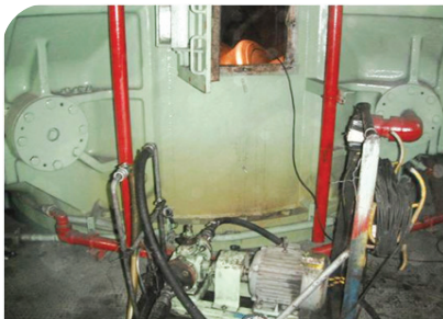
미분기 상부 Manhole Open
