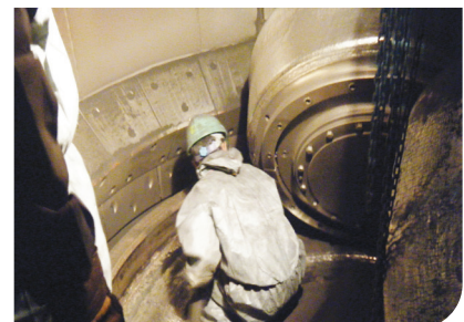
미분기 내부 점검 작업
