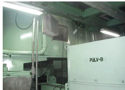
미분기 하부 Manhole Open
